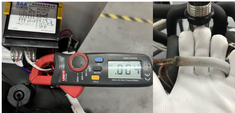
【左图：白色高温线为压缩机共端。右图：蒸发器入口铜管结霜现象】
