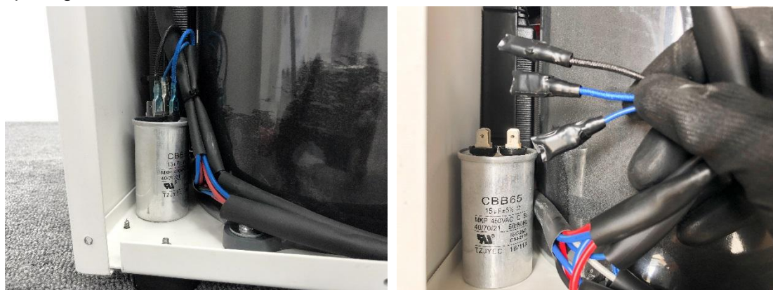
【左图：压缩机启动电容；右图：使用电工胶布将接线端子不留触点完整包好】
